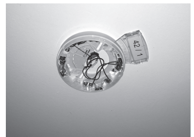
Brandmeldeanlage Bildungshaus Batschuns
